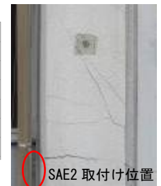
写真 3 損傷状況 (実験終了後)
