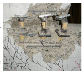
写真 1 WX4 接合部損傷状況
