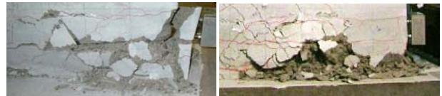
写真 2 実験終了後端部圧壊状況 W1T W2T
